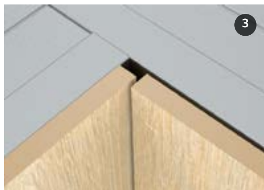
Joint ouvert dan l'angle entrant
